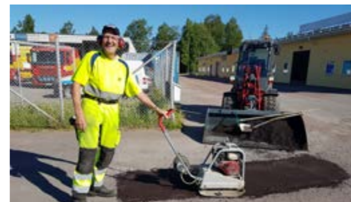
Nisse lagar tjälskador, vintern har ställt till det på många ställen.
